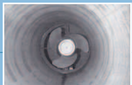
Particolare di pompa di ricircolo Detail of a recirculation pump
